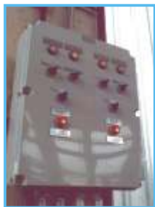
Řídicí rozváděč RPA
